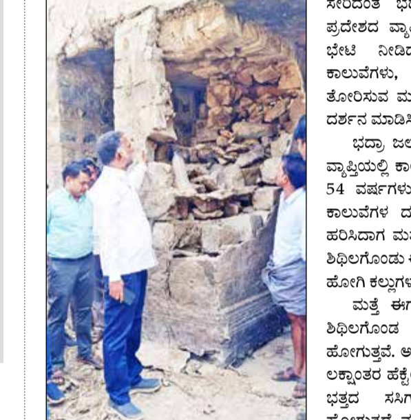
ದಾವಣಗೆರೆ, ಜಿ. 2 - ಮಾಯಕೋಡ ಕ್ಷೇತ್ರದ ಭದ್ರಾ ಜಲಾಶಯದ ಅಚ್ಚುಕಟ್ಟು ವ್ಯಾಪ್ತಿಯ ಶಿಥಿಲಗೊಂಡ ಕಾಲುವೆ ಮತ್ತು ಸೇತುವೆಗಳನ್ನು ಶಾಸಕ ಕೆ.ಎಸ್.ಬಸವಂತಪ್ಪ ಮಂಗಳವಾರ ಅಧಿಕಾರಿಗಳೊಂದಿಗೆ ಭೇಟಿ ನೀಡಿ ಪರಿಶೀಲನೆ ನಡೆಸಿದರು. ರೈತ ಮುಖಂಡರ ಒತ್ತಾಯದ ಹಿನ್ನೆಲೆಯಲ್ಲಿ ಮಾಯಕೋಡ ಕ್ಷೇತ್ರದ ವ್ಯಾಪ್ತಿಯ ಕುರ್ಚಿ, ಕಲ್ಯಾಣ, ಅಣಬೇರು, ಹಿರೇತೋಗಲೇರಿ ಭದ್ರಾ ಜಲಾಶಯ ಅಚ್ಚುಕಟ್ಟು ಪ್ರದೇಶದ
